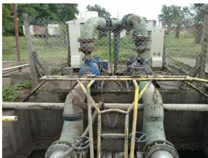
FG107: Equipo de bombeo para ampliar el sector de riego con efluente
